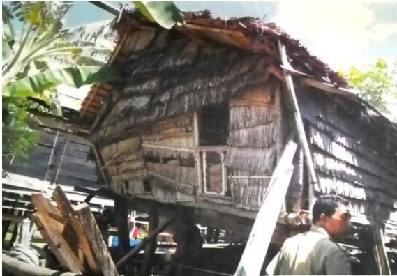
Gambar 3.8. Rumah Tidak Layak Huni
